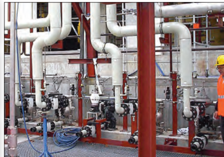
Pompes à membrane en acier inoxydable 2" (50,80 mm) assemblées avec des antipulsateurs en PVDF, utilisées pour pomper de l'acide fluorhydrique
