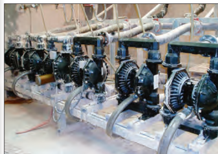
Pompes à membrane 3" (76,20 mm) montées sur un châssis, permettant de transférer de l'argile dans une usine de fabrication de céramique
