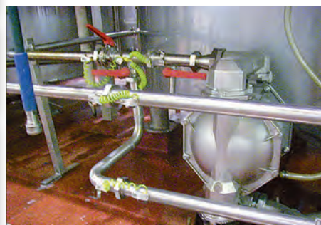
Pompe de transfert sanitaire 3" (76,20 mm) utilisée pour transférer la substance de base nécessaire à la fabrication de shampoings
