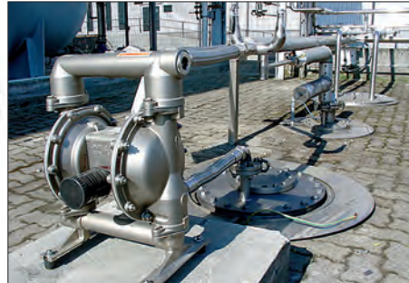
Pompe à membrane 1 1/2" (38,10 mm) installée dans une usine de traitement chimique et permettant le transfert du chlorure de méthylène
